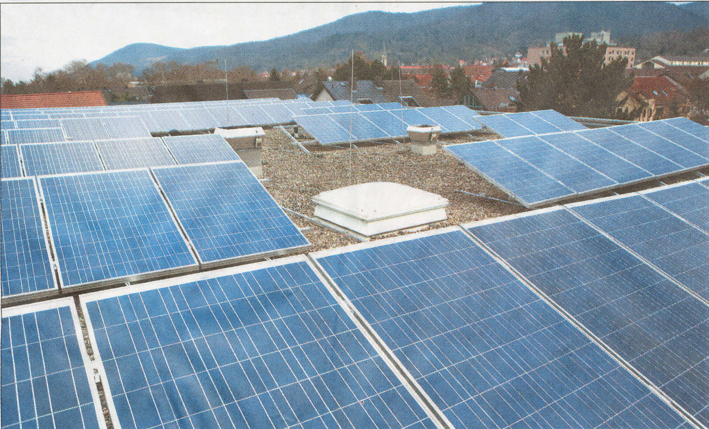
133 Solarzellen-Module auf dem Dach versorgen jetzt die Klinik St. Elisabeth in Neuenheim mit umweltfreundlicher Energie. Foto: Sven Hoppe
